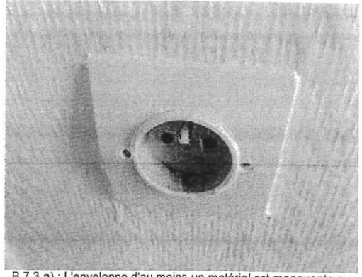
B.7.3 a) : L'enveloppe d'au moins un matériel est manquante ou détériorée.
