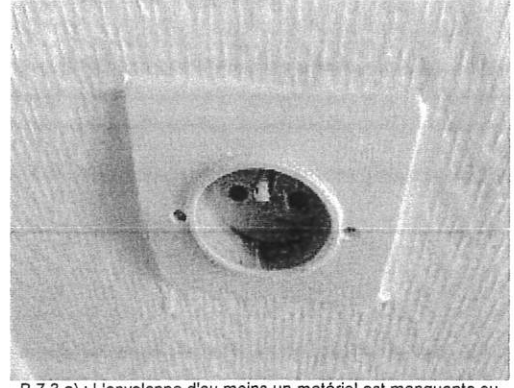
B.7.3 a) : L'enveloppe d'au moins un matériel est manquante ou détériorée.
